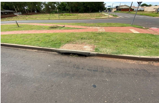
Imagem 23 – Galeria de águas pluviais/Boca de lobo em frente ao local do futuro empreendimento.
