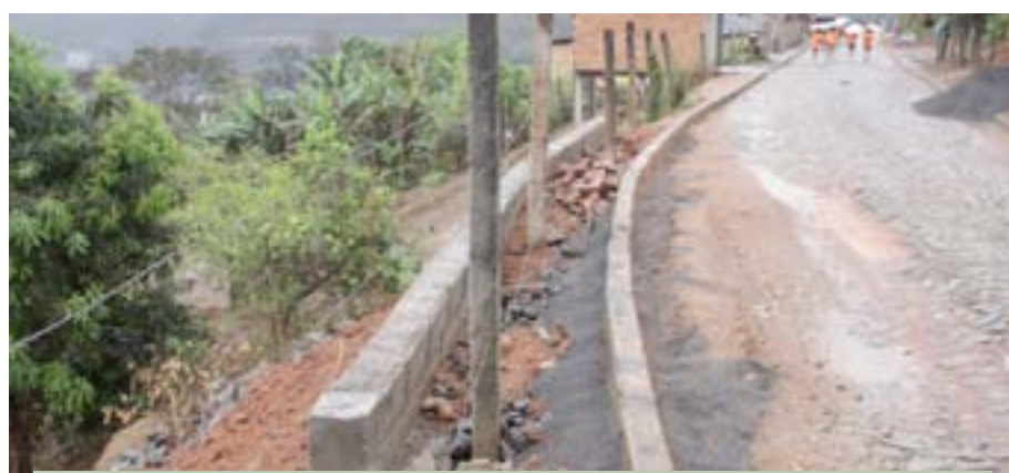
Trecho da rua Principal, no bairro Pedreira, ganhou muro de arrimo para contenção de um barranco
