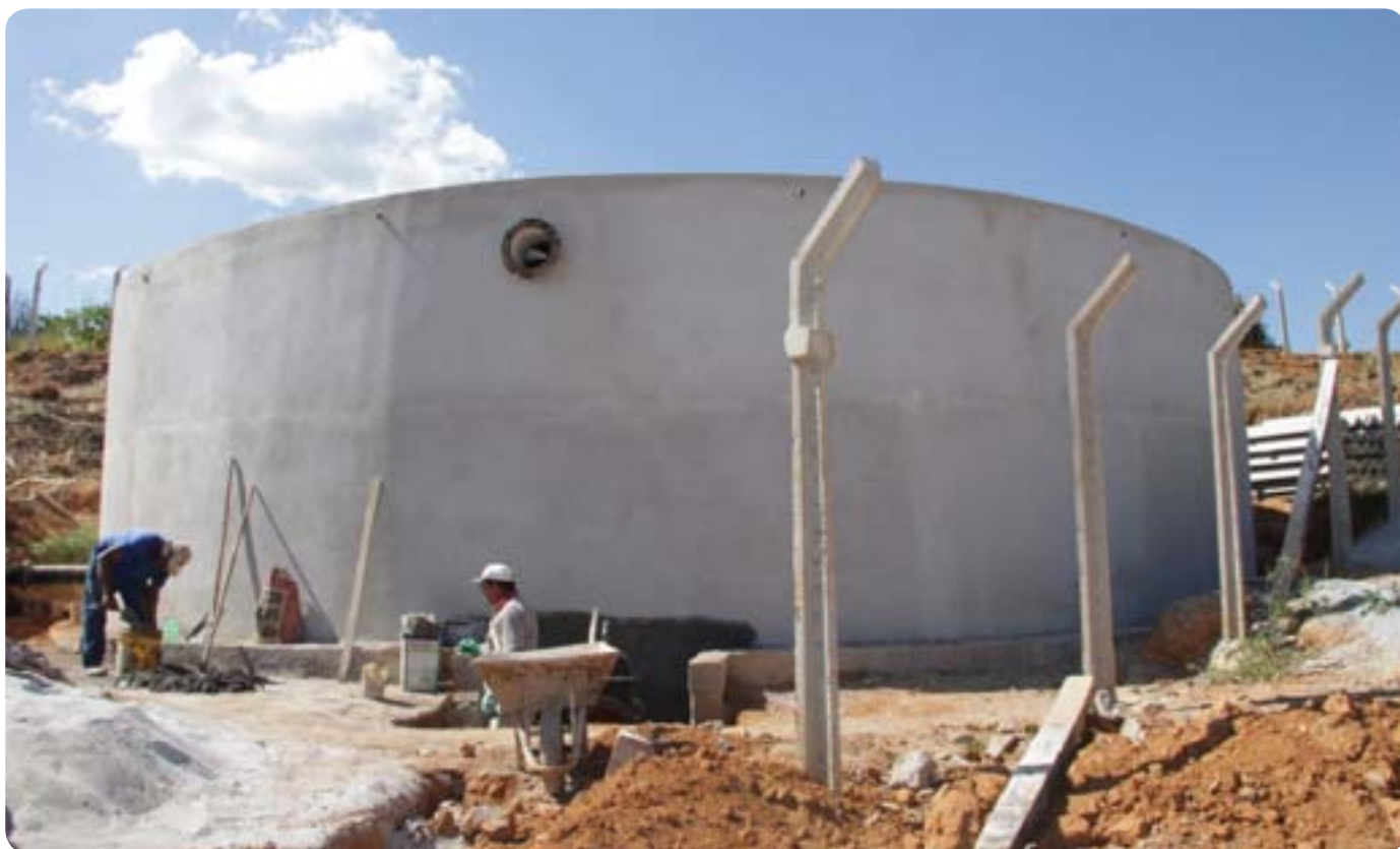
Reservatório com capacidade para 400 mil litros será inaugurado dia 22 de março
