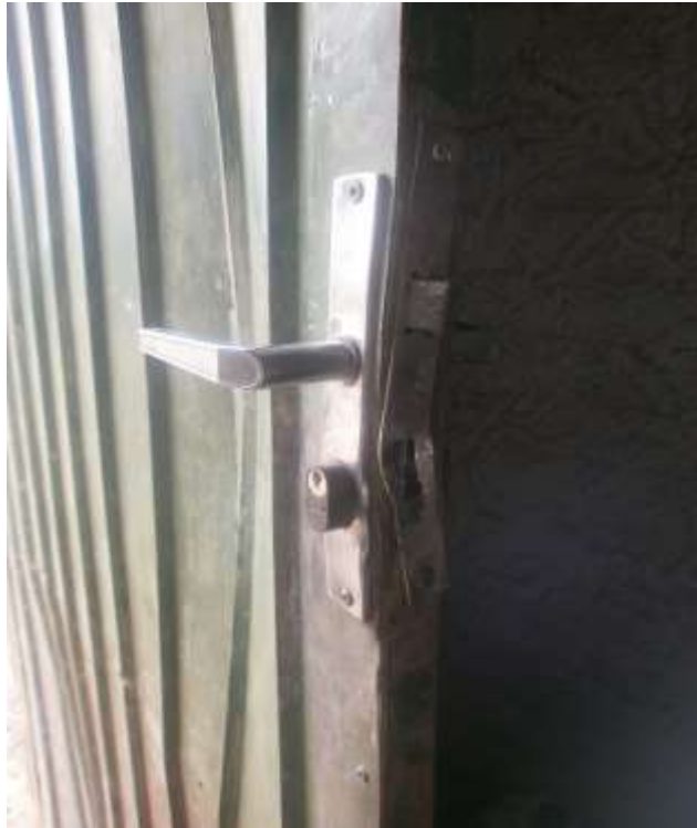
Foto 56: Porta do depósito arrombada Fonte: Prefeitura Municipal
