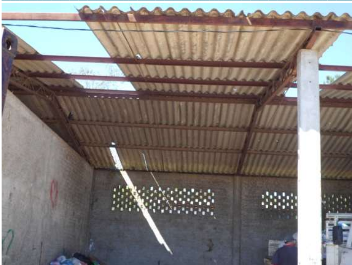
Foto 62: Cobertura com avarias Fonte: Prefeitura Municipal
