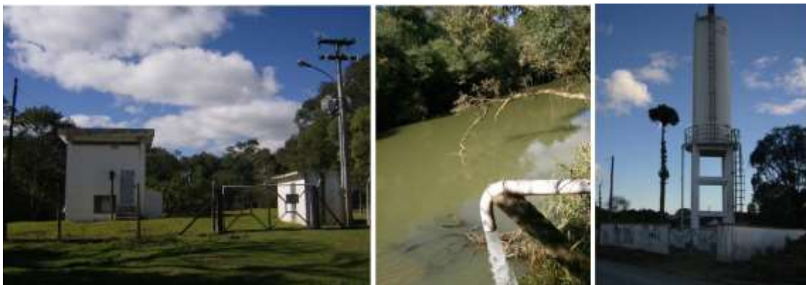
Foto 8: Estação de captação no Rio dos Patos Fonte : Plano Municipal de Recursos Hídricos
