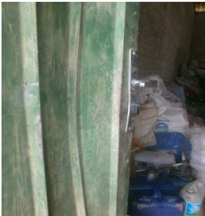
Foto 57: Porta do depósito arrombada Fonte: Prefeitura Municipal
