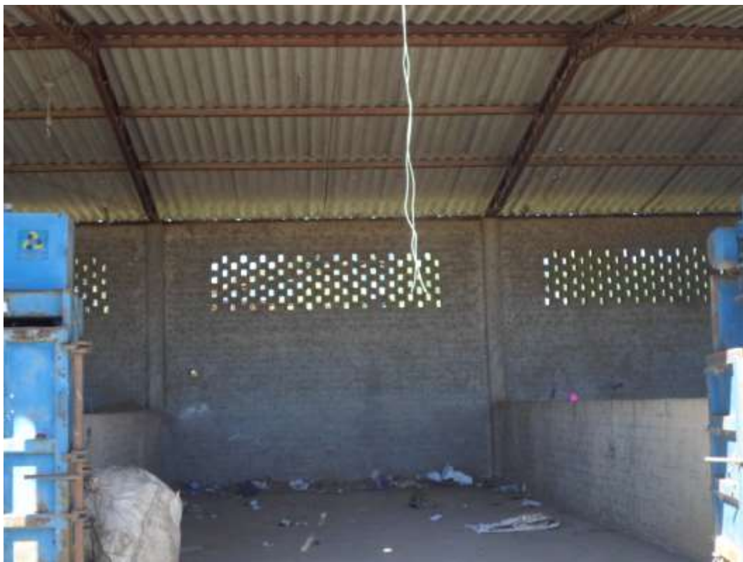
Foto 59: Fiação deteriorada e prensas abandonadas Fonte: Prefeitura Municipal
